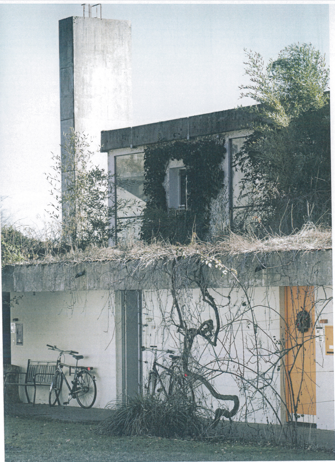
Halen-Reihenhäuser in Herrenschwanden in der Gemeinde Kirchlindach bei Bern: Hinter überwucherten Wänden bröckelt nach gut fünfzig Jahren der Beton.
