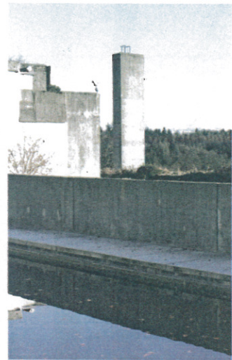
Problemzonen an den Dachrändern.
